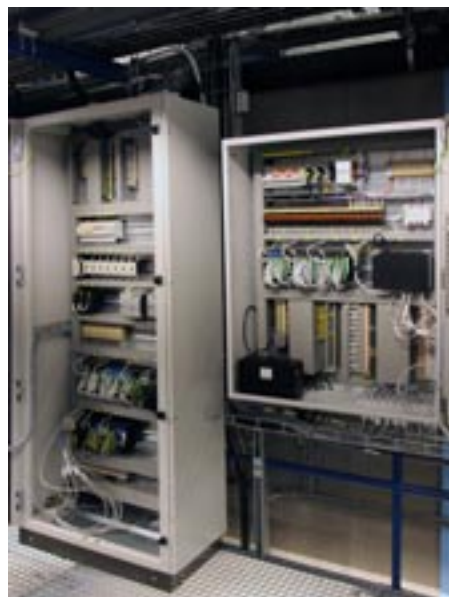
Jednotky DataLab v technologickém rozvaděči
