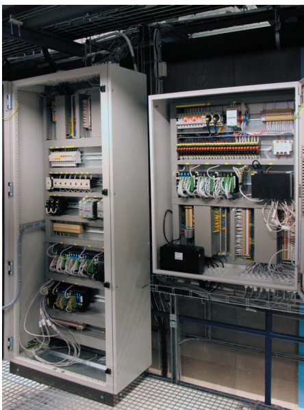
Jednotky DataLab v technologickém rozvaděči
