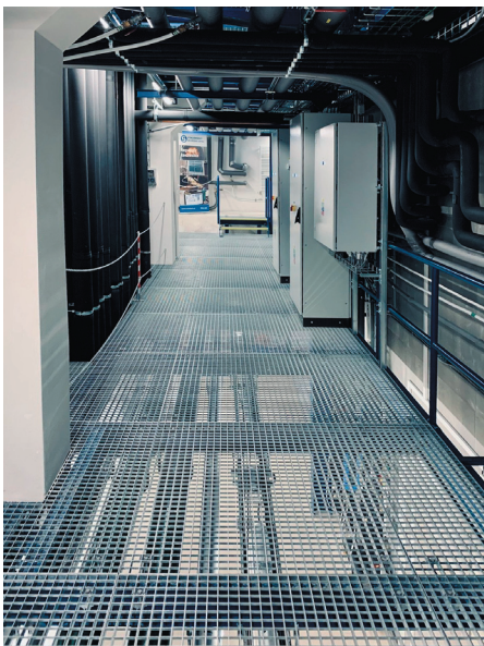
Jeden z technologických rozvaděčů v patře nad zkušebními komorami
