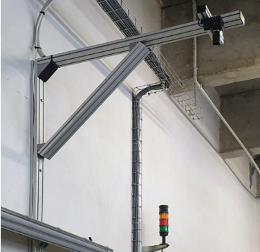
Kamera DataCam je umístěna nad paletami se sklenicemi
