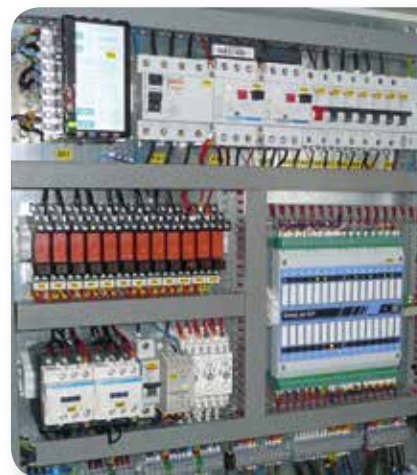
Začlenění jednotky DataLab do rozváděče
