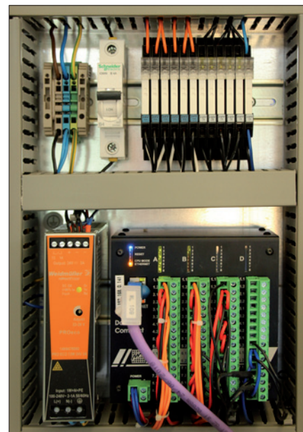
Obr. 5. Rozváděč stroje s jednotkou DataLab
