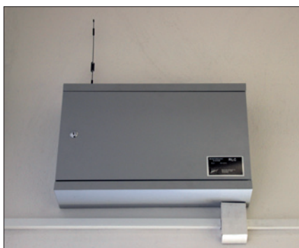
Obr. 3. Síťové přepínače jsou bezpečně uloženy v rozvodných skříních vždy vysoko na zdech výrobních hal
