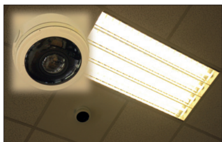
Obr. 8. Podstropní montáž panoramatické kamery
