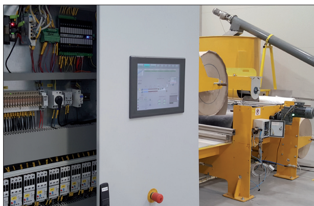
Obr. 6. Efektivní automatizace výrobní linky se systémem Control Web: počítač s grafickým rozhraním pro obsluhu a v rozváděči jednotka DataLab pro řízení stroje připojená prostřednictvím Ethernetu
